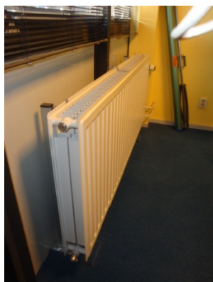
Figuur 2: Radiator in het kantoor.
